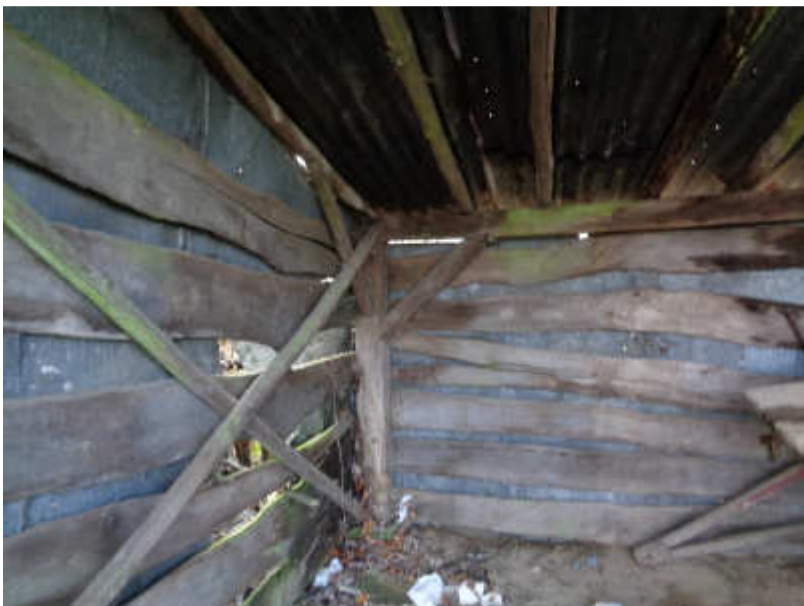
Verfallener Stall in der Baumheckenstruktur, die vom "Kleefeld" Richtung "Bocksiefen" führt.
